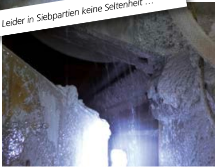
Foto 2: ... Verunreinigungen und Ablagerungen.
