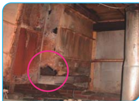
Abb.7 Korrosion am Wärmetauscher
