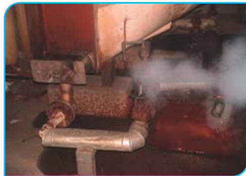
Abb.6 Leck an Rohrleitung
